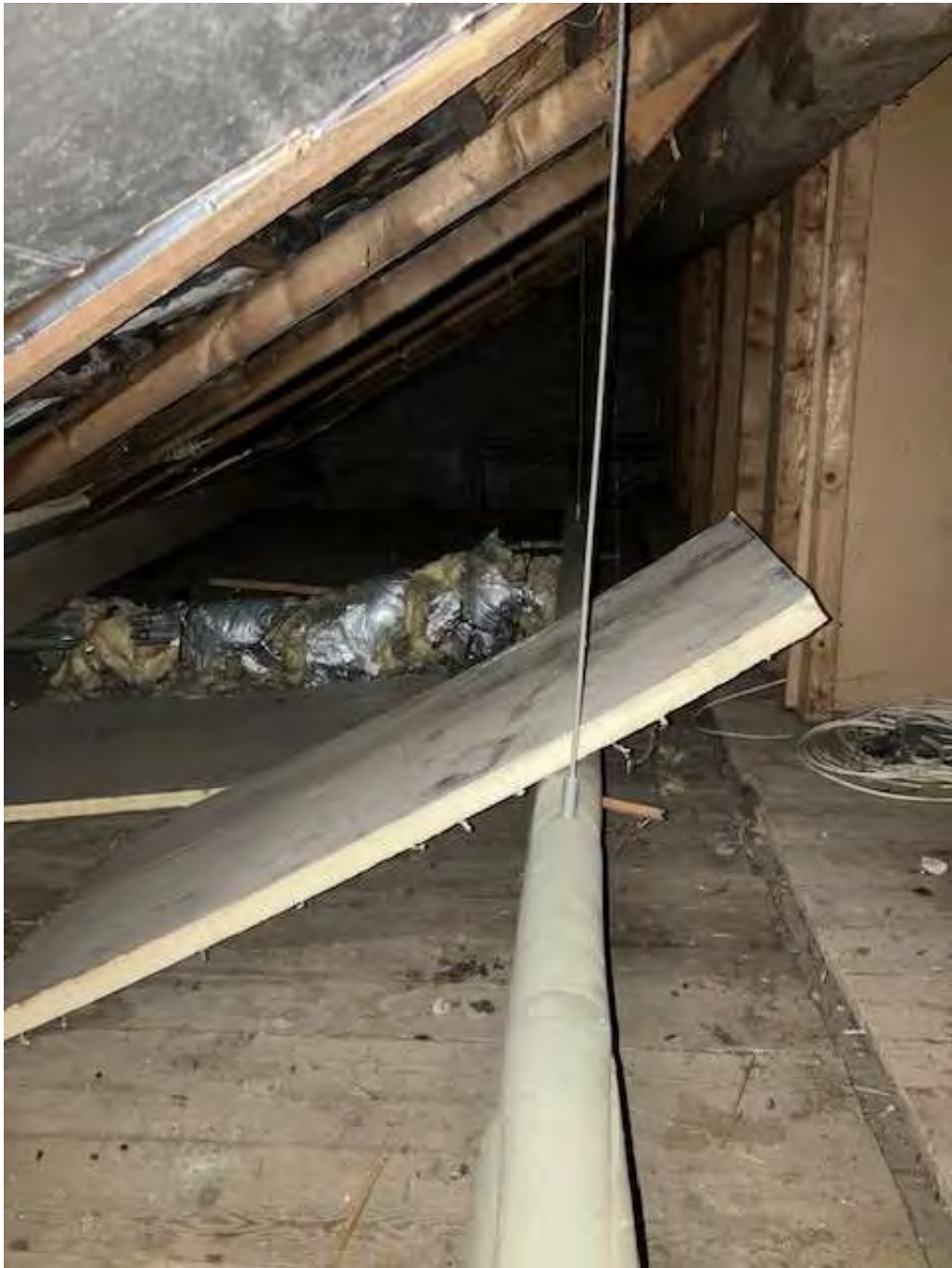
• Afbeelding 23: ruimte onderzijde dak, veel muizenkeutels op de zoldervloer
