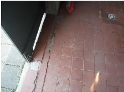
Foto 9 tegelvloer op beton – tegels gelegd in onverdachte specie – opstal 1
