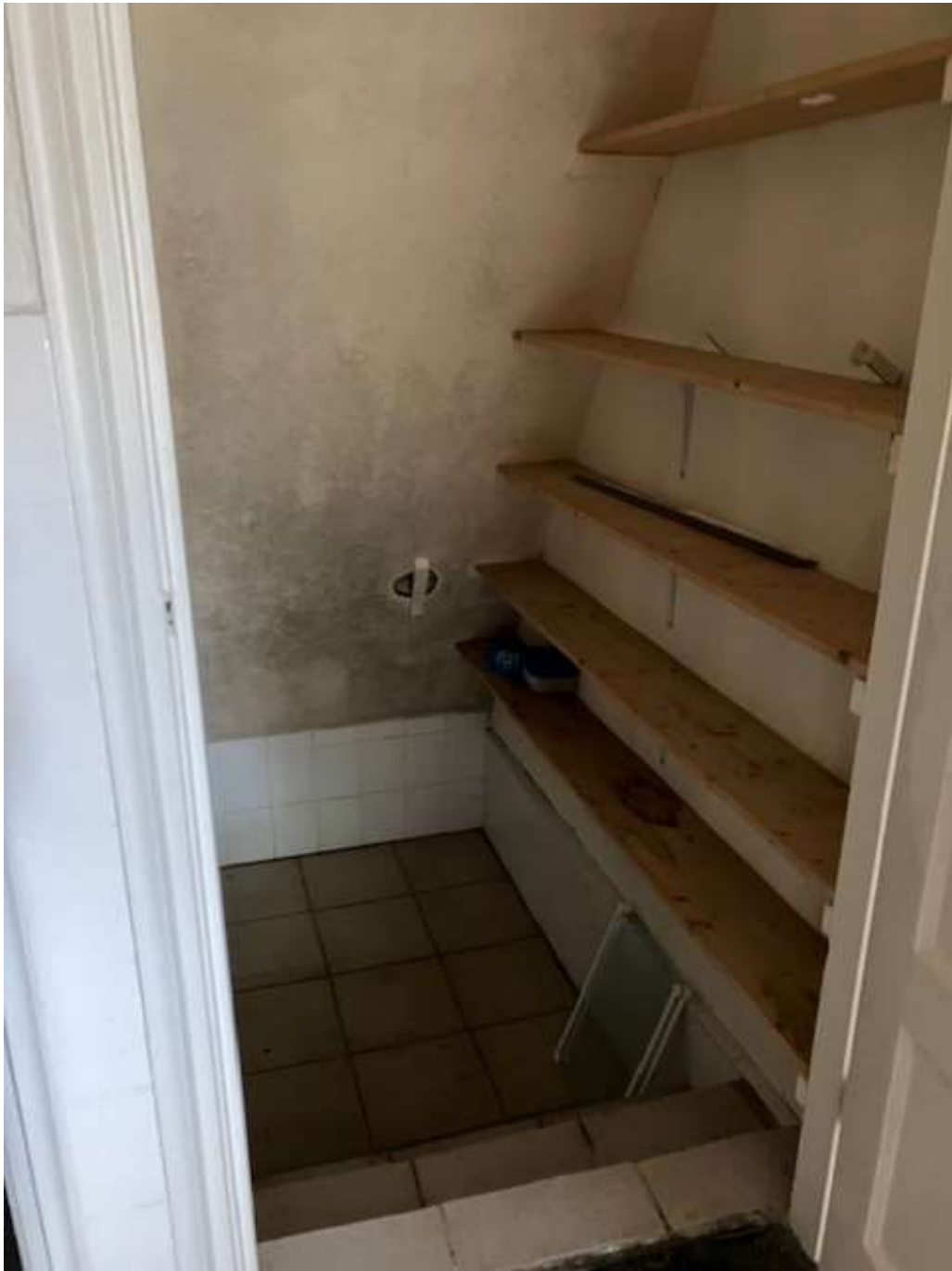
• Afbeelding 17: kelder, staat onder water
