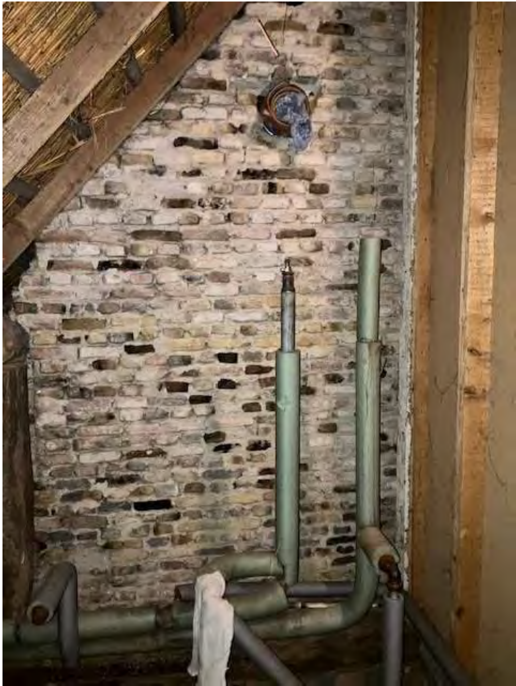
• Afbeelding 22: voormalige cv-locatie aan de onderzijde van de rieten kap
