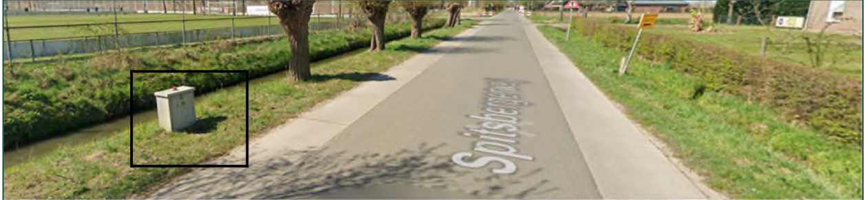
Figuur 3-5 Kast en put van drukriolering tussen de Spitsbergerweg 23 en 27 aan de zuidzijde van de weg. Hier dient mogelijk de overkluizing verlengt te worden.
